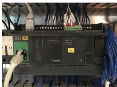
Control PLC de la máquina
